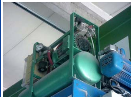
Вакуумный насос 7002-COMP на подкрановом пути
